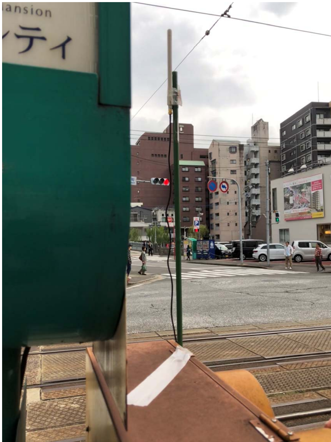
図 4. 賑橋電停に設置したアンテナ
